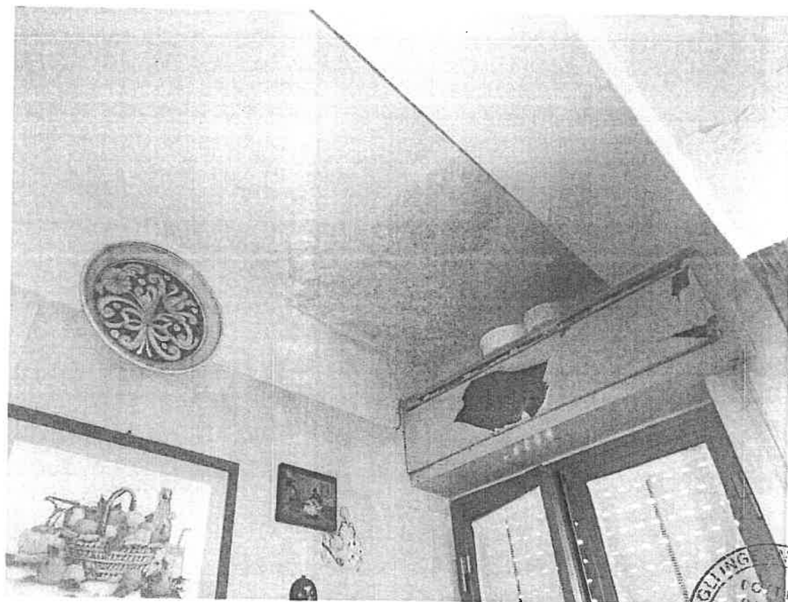
Foto 1: solaio cucina appartamento P.3°
