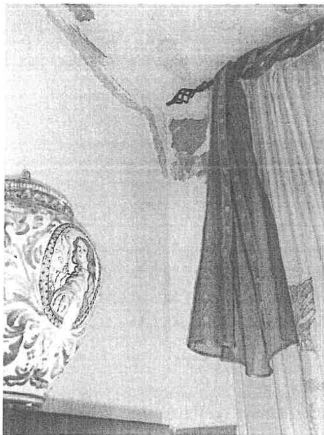
Foto 5: solaio bagno appartamento P.3°
