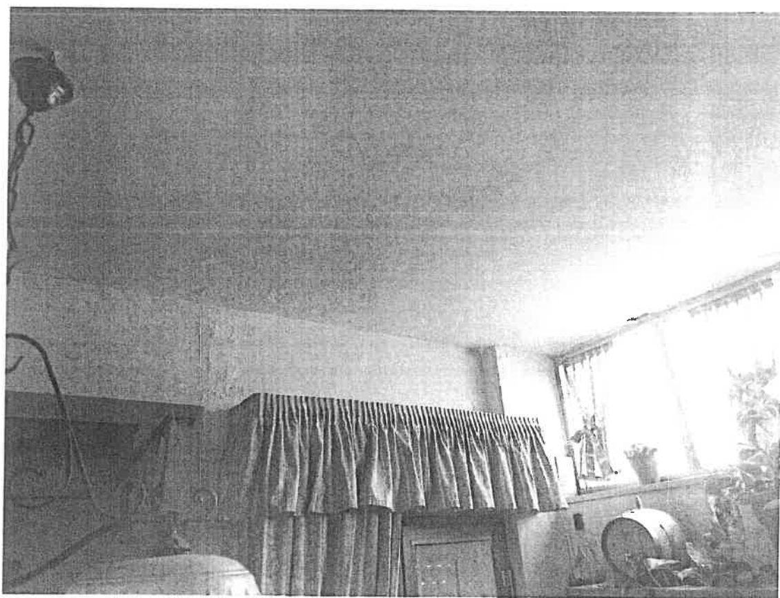
Foto 3: solaio cucina appartamento P.3°
