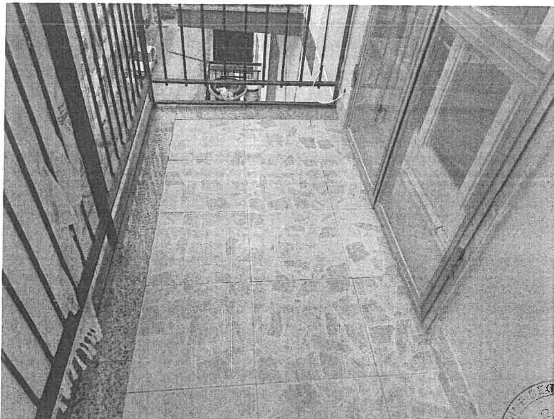
Foto 16: ballatoio appartamento P.4° lato mare (corrispondente al salone del P.3° di cui alla foto 10)
