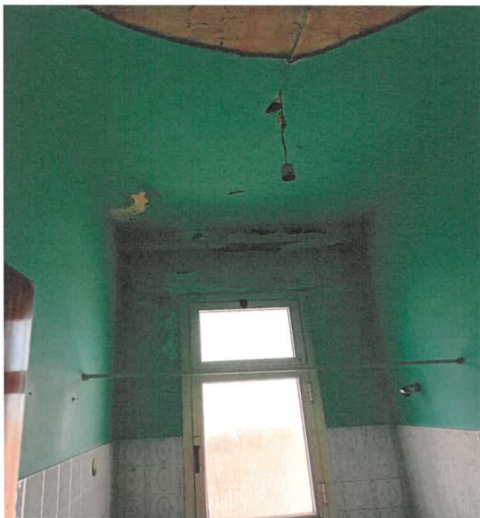
Foto n.ri 31-32 : soffitto locale bagno
