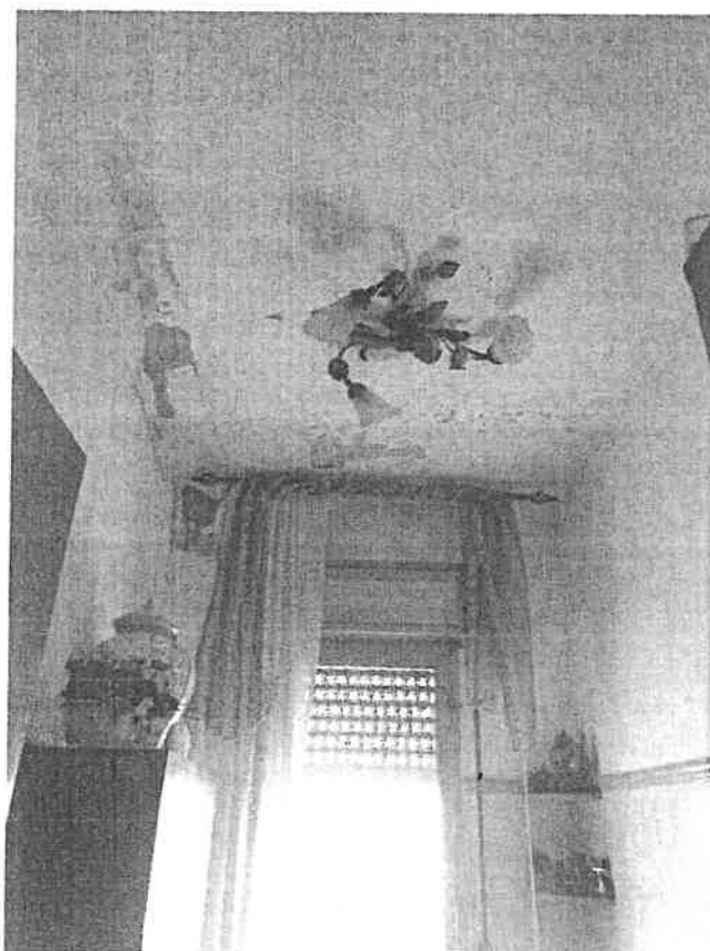
Foto 4: solaio bagno appartamento P.3°
