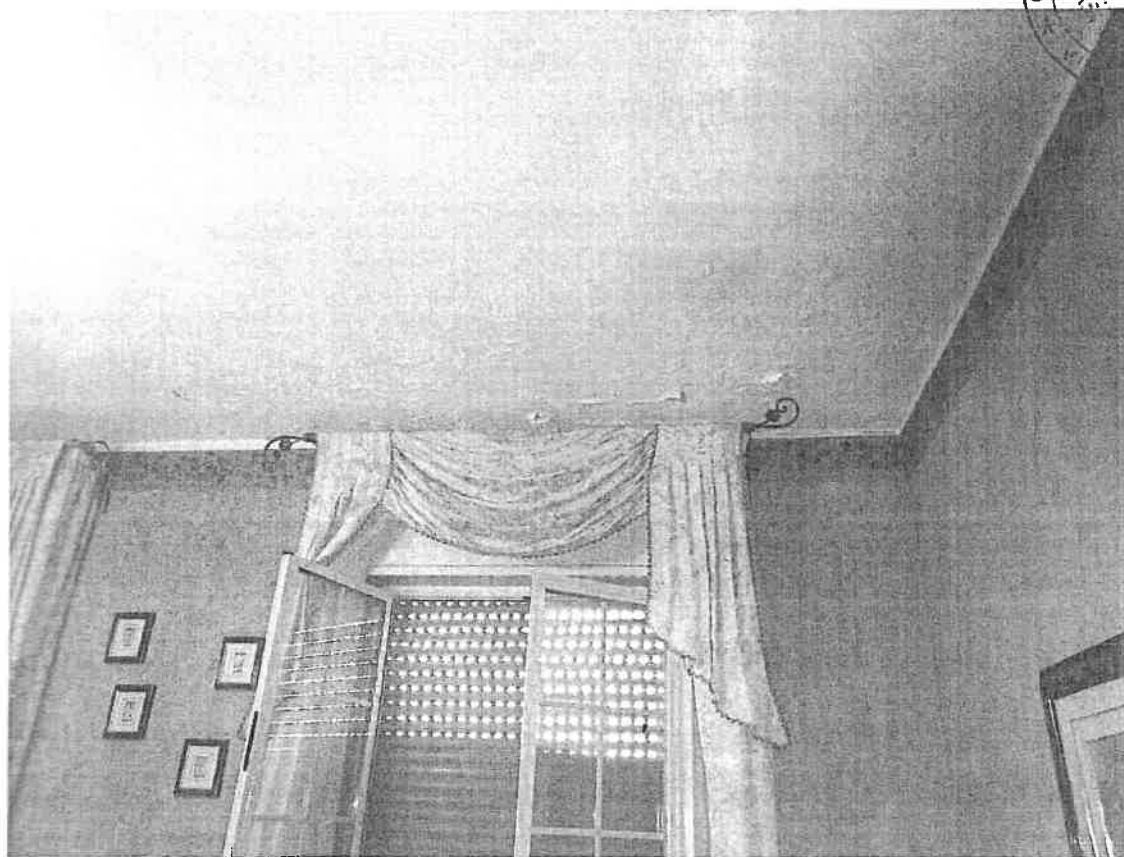
Foto 10: solaio salone appartamento P.3° (danni da infiltrazioni di acqua piovana)
