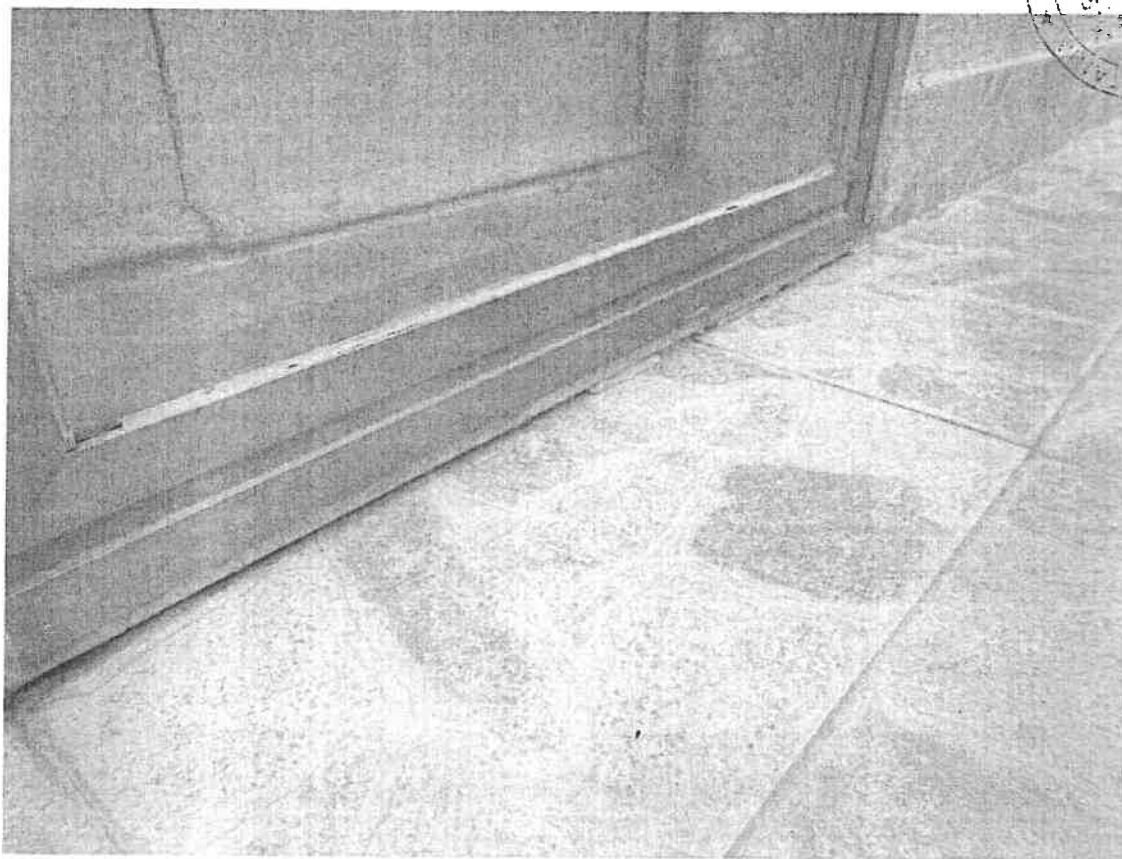
Foto 17: ballatoio appartamento P.4° lato mare (corrispondente al salone del P.3° di cui alla foto 10)
